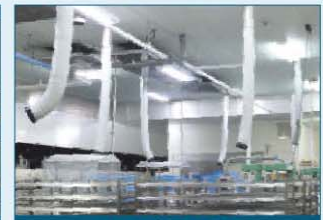
工場内冷房の様子
