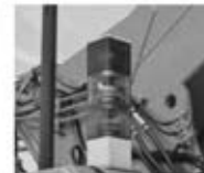
●過負荷外部表示灯
